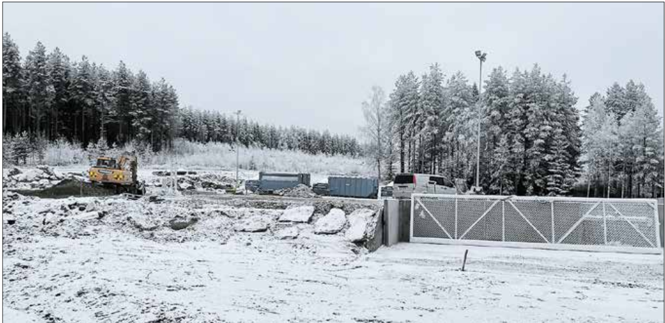
Tämän viikon alussa uudella lajitteluisemmalla oltiin vielä rakennuspuhissa. Muutto uudelle lajitteluasemalle tapahtuu ensi viikon alussa.
