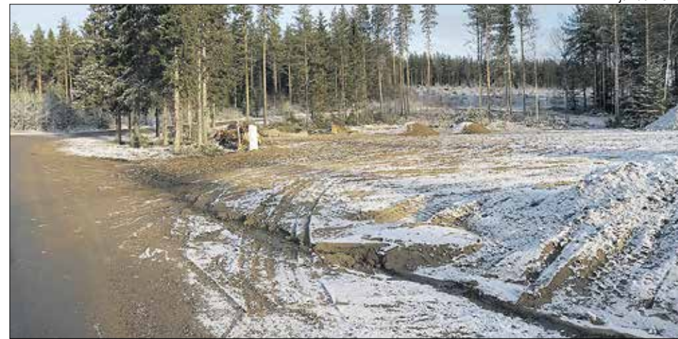
Lajitteluaseman kontit siirretään Lämpökujan varteen lähiaikoina. Varsinaista uutta lajitteluasemaa aletaan rakentaa talven jälkeen.
